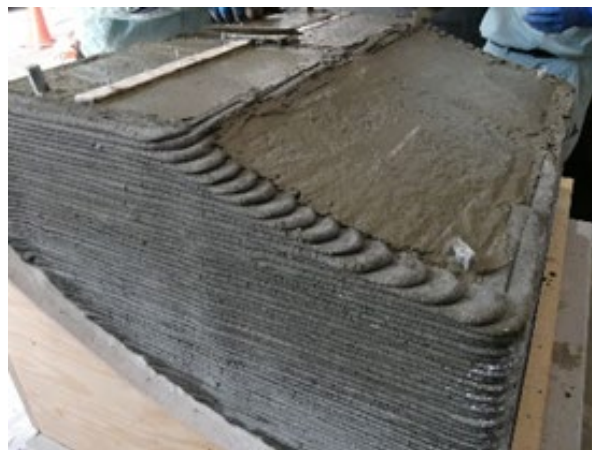
図-13 コンクリート打込み後の状況 Fig.13 State after concrete casting
