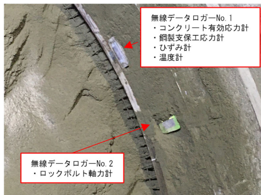
写真-7 設置完了後のデータロガー
