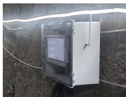
写真-3 通信親機の外観
