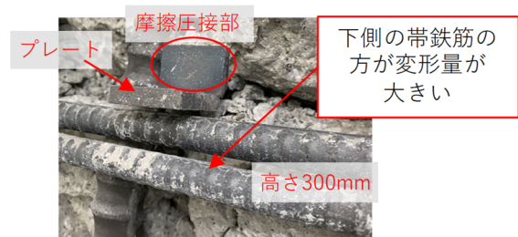
写真-2 プレート損傷状況(Case2)
