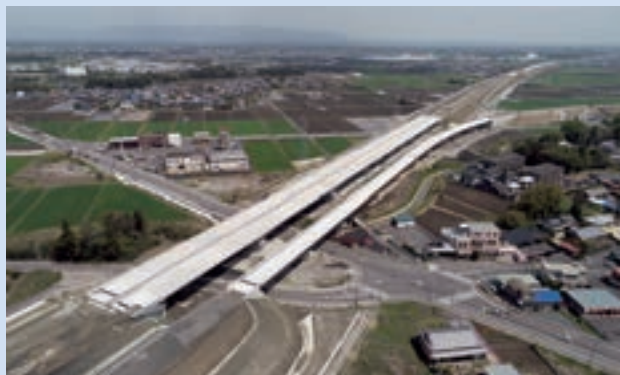
新名神高速道路 潤田高架橋(PC上部工)工事 (三重県三重郡) 発注者: 中日本高速道路株式会社
