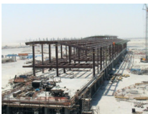
カタール 新ドーハ国際空港旅客ターミナル 複合施設新築工事 (カタール国ドーハ市)
