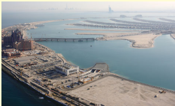
アラブ首長国連邦 パームジュメイラ海底トンネル工事 (アラブ首長国連邦) ナキール社
