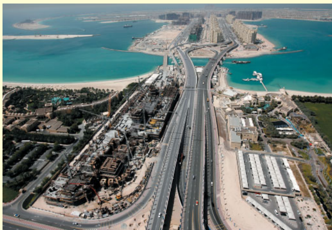
アラブ首長国連邦 ゲートウェイタワーズ&ボディウム新築工事の内低層部建設工事 (アラブ首長国連邦)
