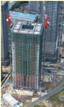
(仮称) MK (武蔵小杉Ⅱ-1街区) プロジェクト新築工事 (神奈川県川崎市)
