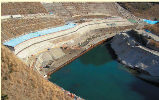
奈良県川上村 白屋地区地すべり対策工事 (奈良県吉野郡)
