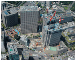
中央合同庁舎第7号館 整備等事業建設工事 (東京都千代田区)
