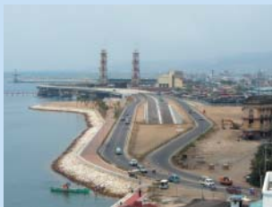
フィリピン セブ南海岸道路 第3工区（橋梁工事） （フィリピン共和国セブ市） 発注者：フィリピン政府公共事業道路省
