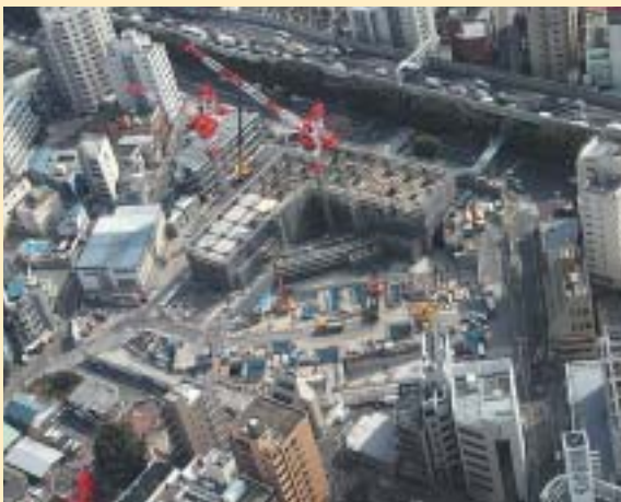
東池袋四丁目地区第一種市街地再開発事業 施設建築物他新築工事（その1） （東京都豊島区）
