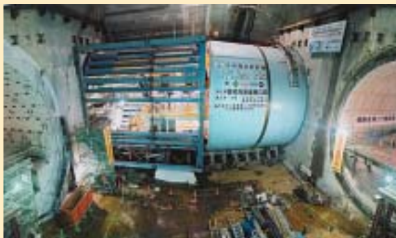
中央環状新宿線代々木シールドトンネル（内回り） （東京都渋谷区）
