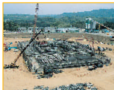
実大三次元震動破壊実験施設 震動台基礎外工事 (兵庫県三木市三木震災記念公園内) *世界最大の震動実験施設
