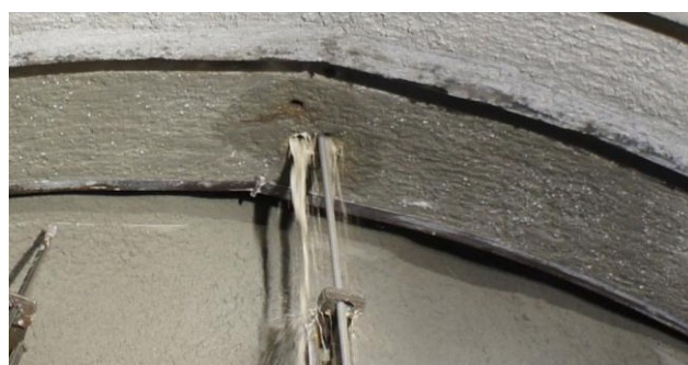
写真-2 ドリルジャンボによる削孔 Photo.2 Drilling by the drill jumbo
