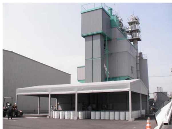
写真-9 UFCバッチャープラント Photo 9 UFC batching plant
