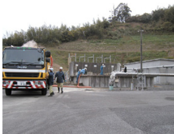
写真-1 茂原 DA-7 号井の気液分離槽 Separator of DA-7 Well, Mobara
