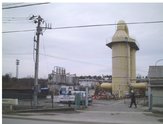
写真-3 新潟 K6 号井の気液分離槽 Separator of K6 Well, Niigata
