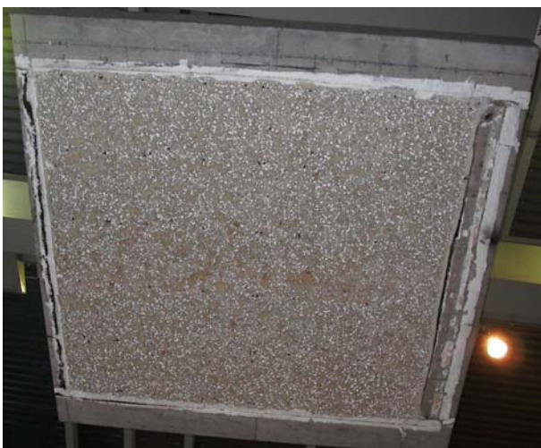
写真-3 鉄筋コンクリート試験体(RC)加熱面状況 Post-heating surface of reinforced concrete specimen
