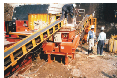
吹付けプラント
