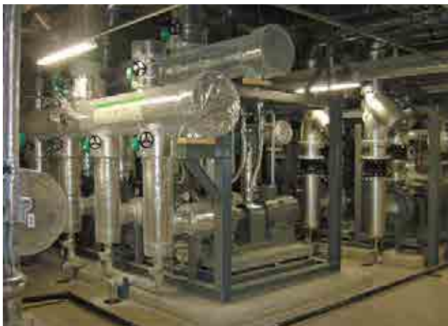
冷温水ポンプ（空調用の冷温水を空調機に運ぶ）
