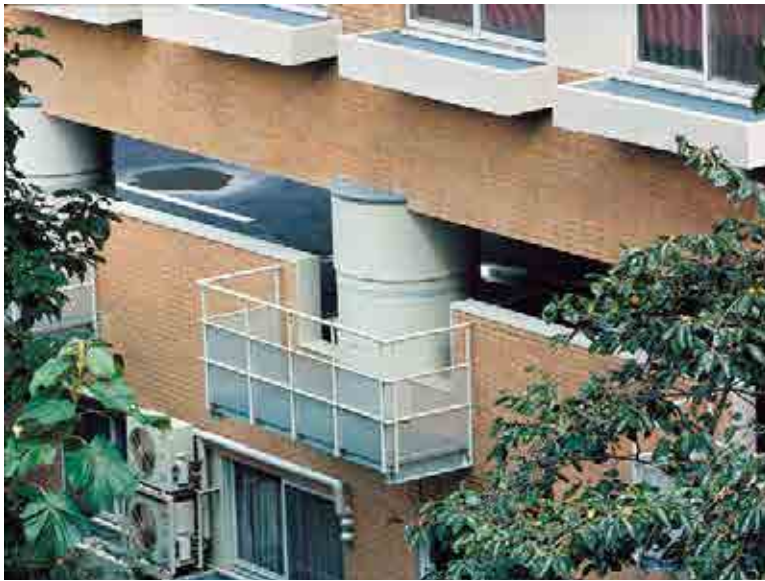
湯河原研修クラブ 8階の柱を切断し、 積層ゴム免震装置を挿入した世界初の中間階免震
