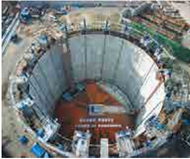
深さ 40m の地下タンク底部でつくった鉄筋コンクリート製ドーム屋根のリフトアップ
