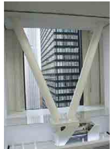
新宿センタービルに設置された制振ダンパー
