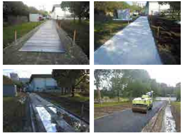
給電技術道路の施工(左上から時計回りにGND施工、基層施工、表層施工、送電電極施工)
