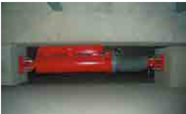
セミアック免震のオイルダンパー
