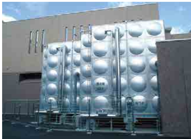
受水槽（水道本管から引き込まれた水を貯める）
