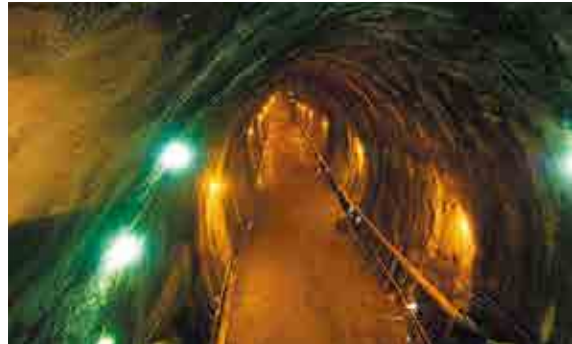
水封式地下岩盤貯蔵方式による波方国家石油ガス備蓄基地
