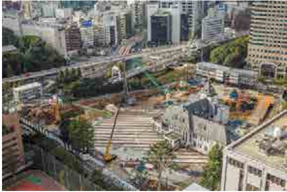
旧グランドプリンスホテル赤坂 旧館 (旧李王家東京邸) 曳家工事状況
