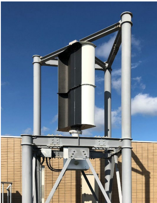
写真1 垂直軸型サボニウス式風車 (大成建設(株)技術センターでの設置状況)
