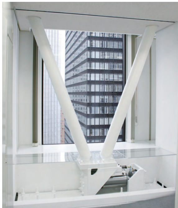
新宿センタービルの設置事例
