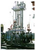
配管ユニット
