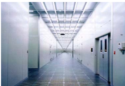
■工業用クリーンルーム
